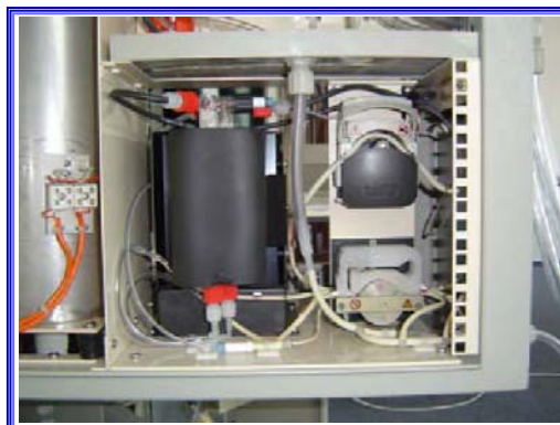
Four, condenseur à effet peltier, têtes de pompe d'échantillon, acide et drains
