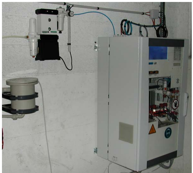
Rejets d'usine d'incinération d'ordures ménagères
