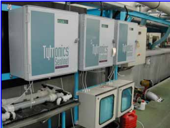
Suivi de composition de bains de traitement de surface
