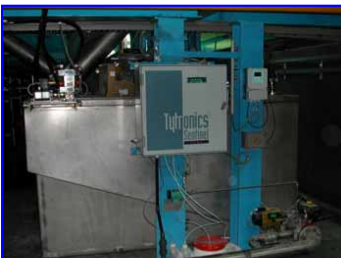
Suivi de fabrication Soude / Carbonate
