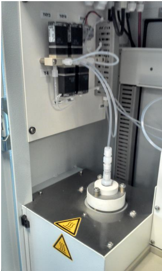
Détails des vannes et du port d'injection
